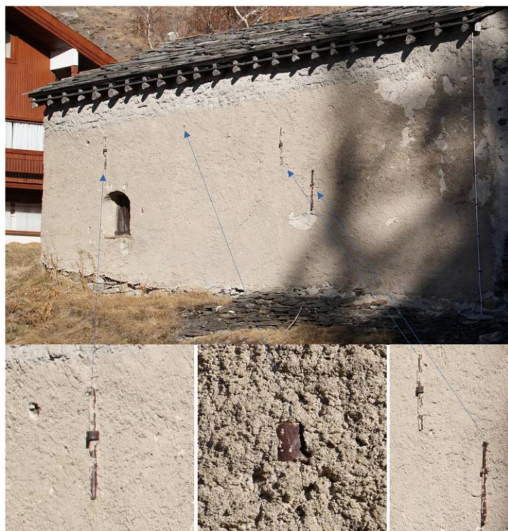
Figure 5 Ancres des tirants métalliques sur la façade ouest, et ancre de la poutre de gloire (faiblement visible)
